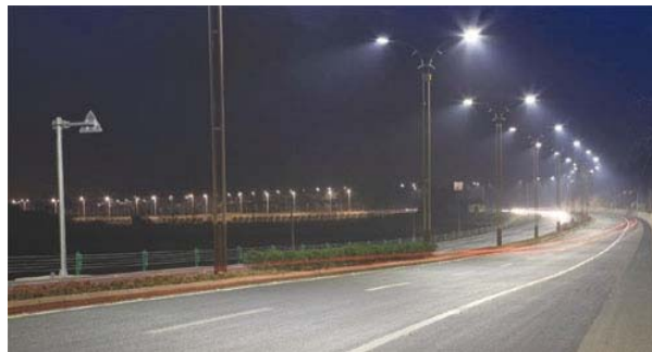
四川绵阳山东大道 LED 路灯示范工程
