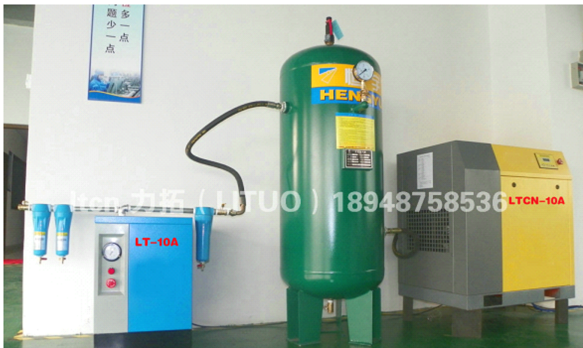
空气压缩一体化实际安装图（10HP 线 流量 1,2M3/MIN 0.8-1.0MPa)满足一条 SMT 生产线）
